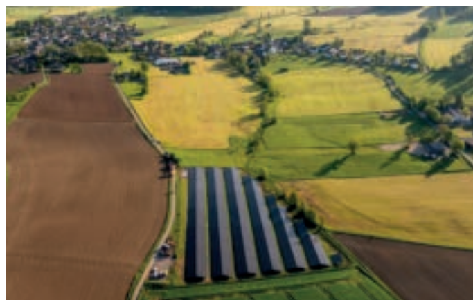
Innovative und nachhaltige Technologien gehören mittlerweile zum Handwerk des Elektroniker-Berufes. Ein Paradeprojekt ist die Photovoltaik-Freiflächenanlage in Mellen, die Busche Elektrotechnik geplant und gebaut hat.
