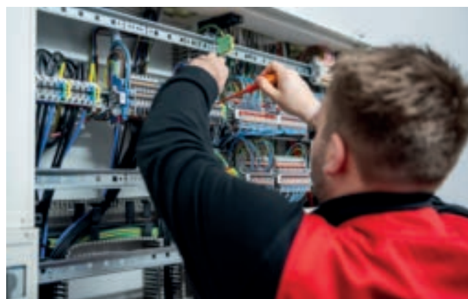
In der unternehmens-eigenen Werkstatt in Balve-Beckum lernen die Auszubildenden zum Beispiel die Montage von Elektro-Schaltschranken.
