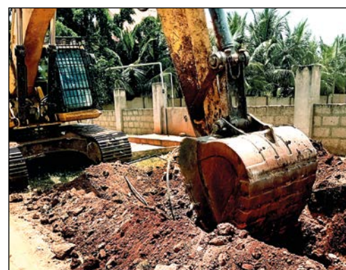
Die Bewässerungsleitung wurde beim Straßenbau zerstört und muss nun neu verlegt werden.
